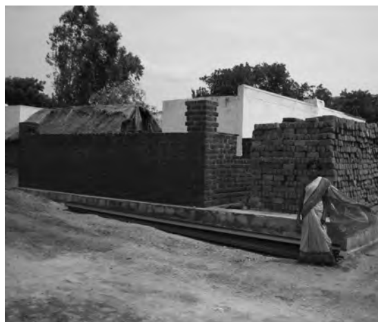
En total s'han construït 28 cases per a famílies de les castes més baixes de la societat.
